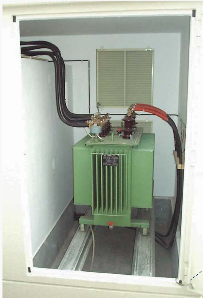
Transformador MT/ BT
