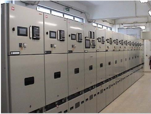
Quadro extraível com disjuntores de vácuo
