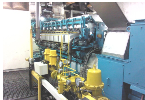
Figura 4 – Motor de combustão instalado no Norteshopping
