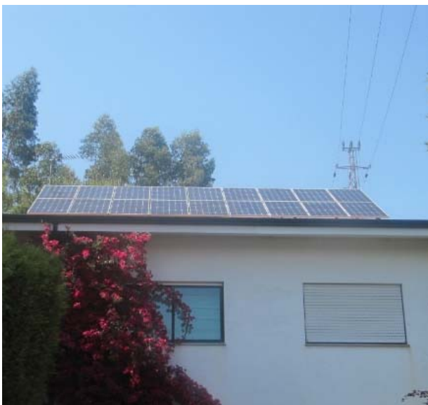
Figura 2.1 – Microprodução FV instalada no telhado da residência do autor
