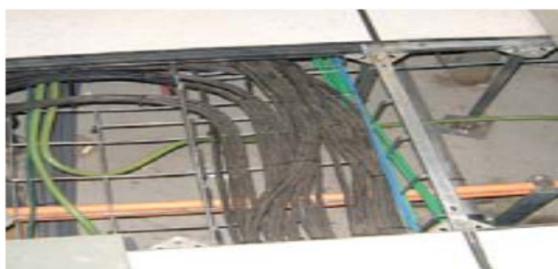
Figura 1. Detecção por aspiração em chão falso
