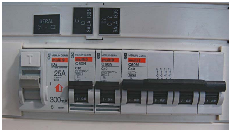
Figura 7: Interruptor diferencial (à esquerda) no quadro do Laboratório 1305
